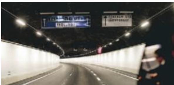
GÖTATUNNELN. En av många tunnlar som kommer att leda trafiken under Göteborg.
